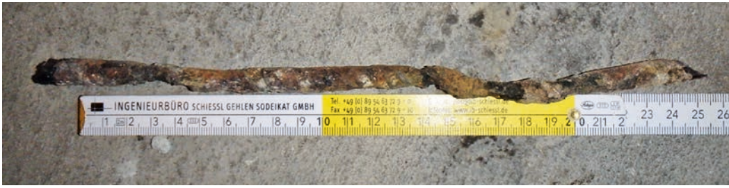
Bild 5 Aktive Bewehrungskorrosion in den Notgehwegen der Tunnelbauwerke Eching und Etterschlag Active reinforcement corrosion in emergency walkways of tunnels Eching and Etterschlag
