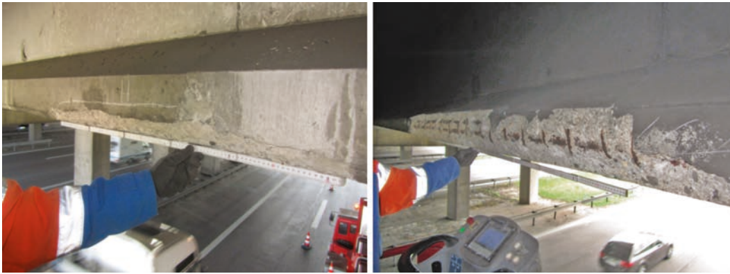
Bild 3 Schäden an den Stegen der Spannbetonträger über den Lkw-Spuren (AK München Ost, BW 17) Damages at prefabricated concrete girders above „truck lane“ (Highway interchange Munich East)
